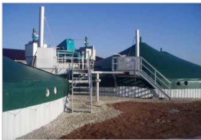
Fermentory jsou zapuštěny do země a plynem opatřeny servisními šachtami míchadel Foto Karel Stober
